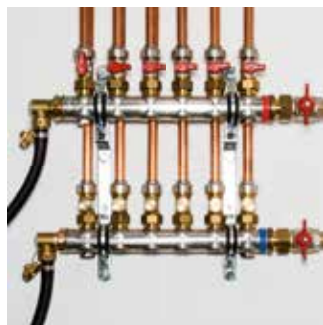
Proplachování radiátorů a plošných topných systémů
